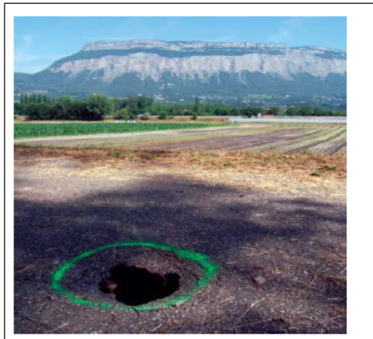
Figure 2.9 Effondrement en crête de digue lié à la décomposition d'une souche (tirée de Vennetier et al., 2015a)
