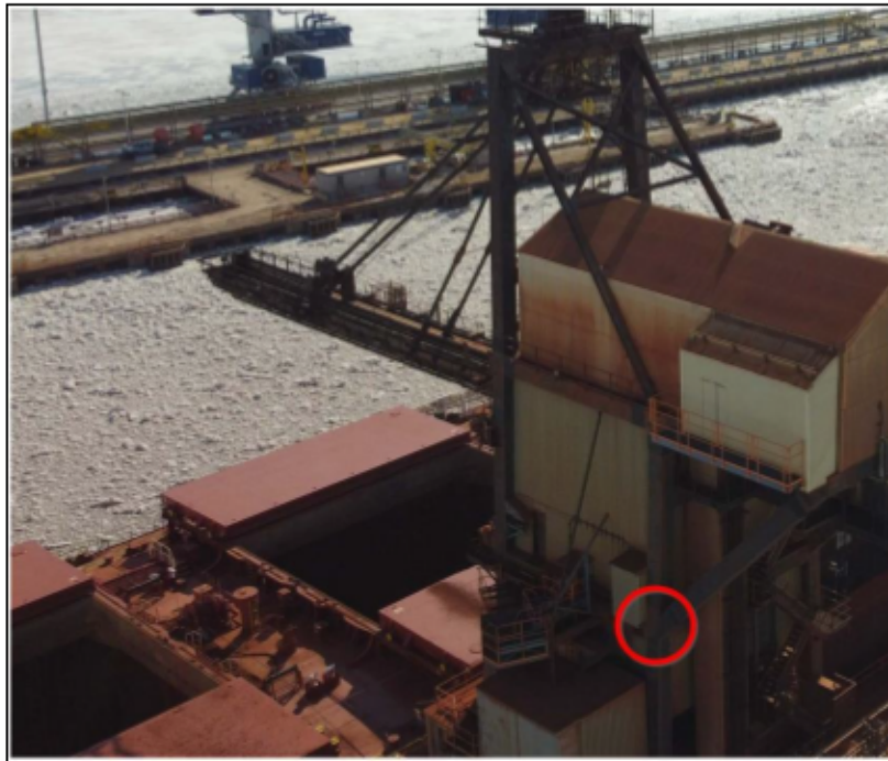
Figure 8 Localisation de fissure au niveau de la grue [19]
