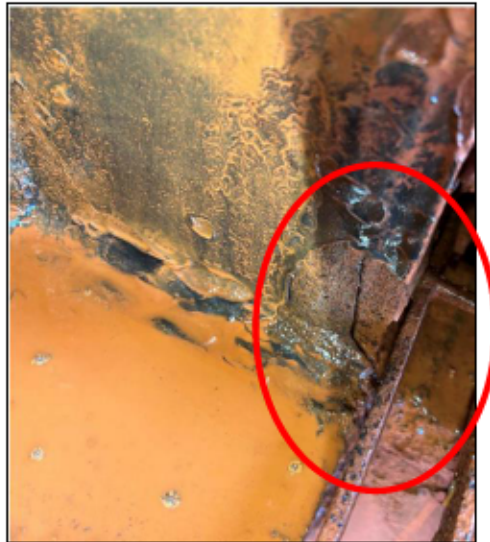
Figure 9 Zone de corrosion au niveau d'une des connexions de caisson [19]
