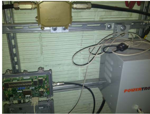
Figure 39 : Système de communication sous-sol
