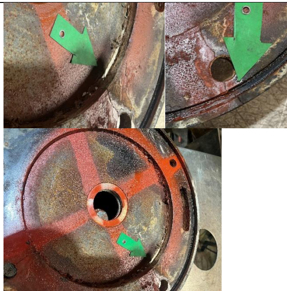
Figure 8 : Fissures de haut corps de pompe
